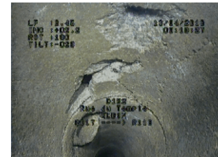
Canalisation dégradée (Passage)
