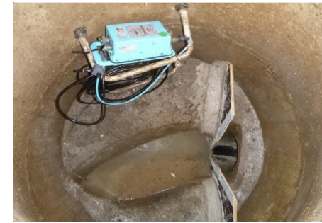
Suivi du débit sur seuil normalisé (Campagne de mesures)
